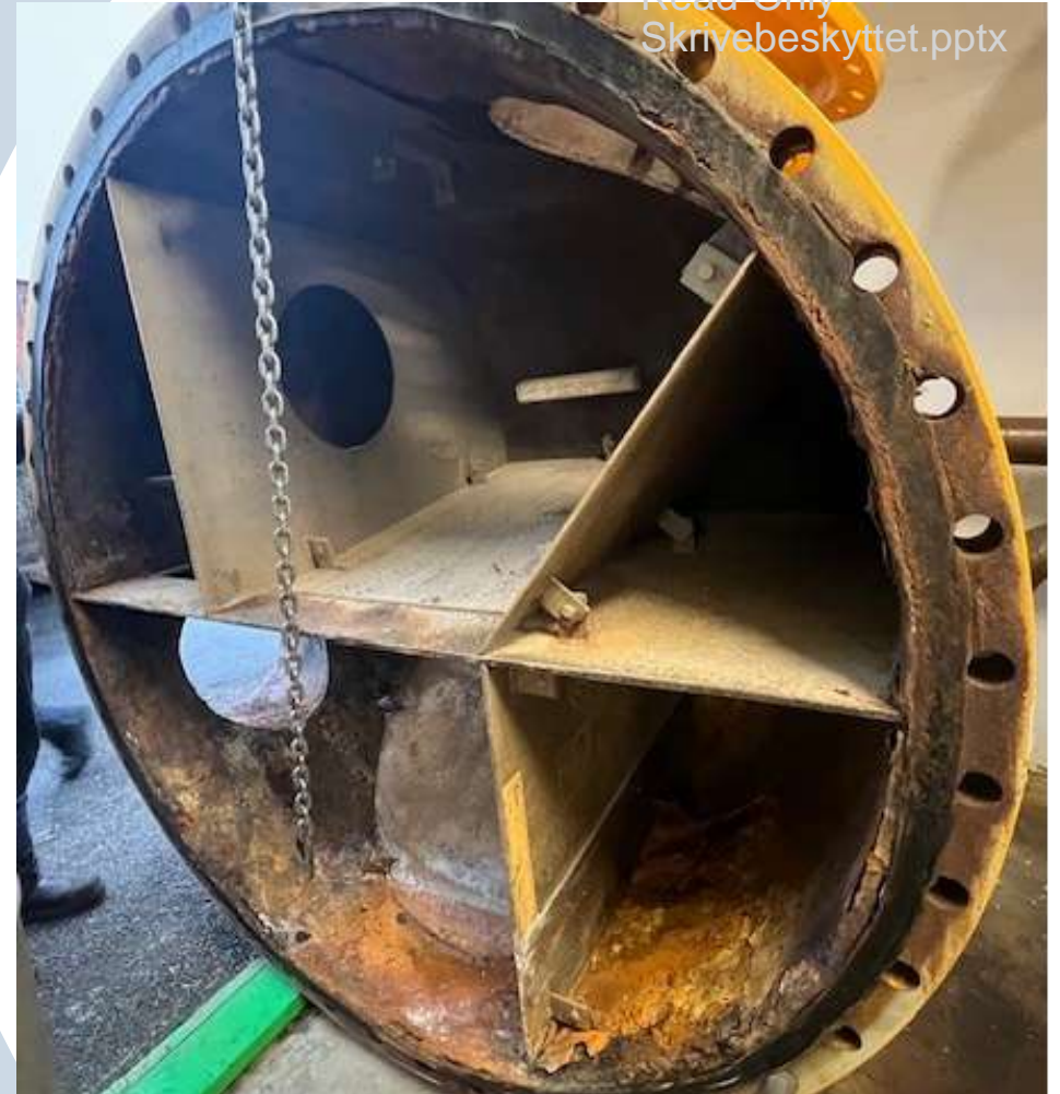
Kraftig tæring i bund på saltvandsside
